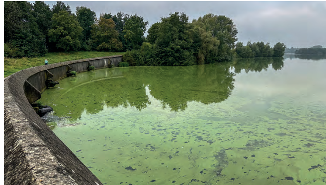
Starker Blualgenbefall im Lippensee im Bereich der Staumauer am Südostufer
